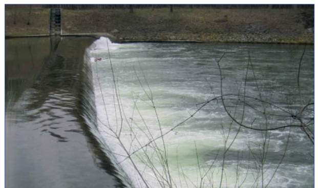
Steilwehr nicht befahrbar, mehrere Unfälle, auch mit tödlichem Ausgang.
